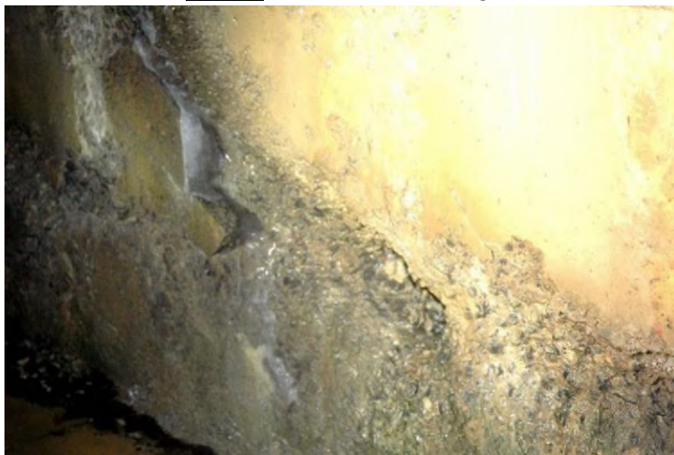
Figura 5: danneggiamento del cls dovuto al gelo, alla base di un piedritto
