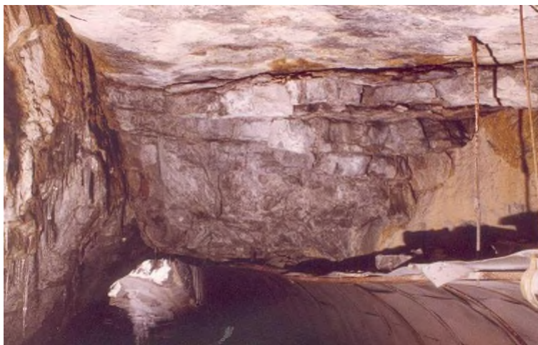
Figure 1: blocco caduto su lamiere di metallo, indicante l'indebolimento della fine di uno strato di roccia calcarea (la presenza di due discontinuità verticali umide ai lati identifica una situazione potenzialmente pericolosa a lungo termine per l'intera parte rocciosa centrale)
