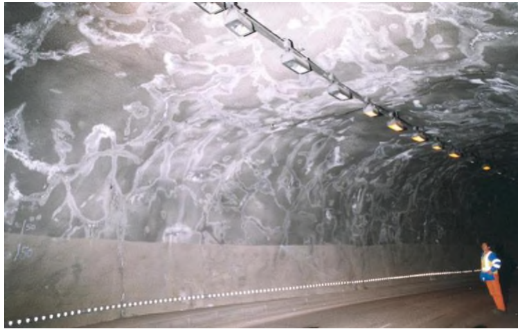
Figura 2: stesso tunnel dopo alcuni anni di esercizio
