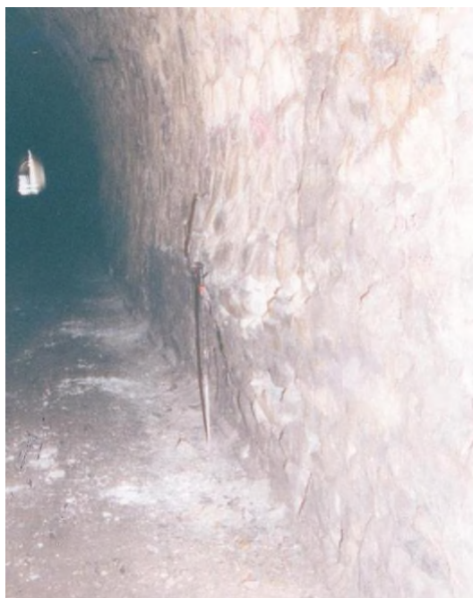
Figura 2: rigonfiamento prossimo alla fase di crollo (muratura significativamente deteriorata)
