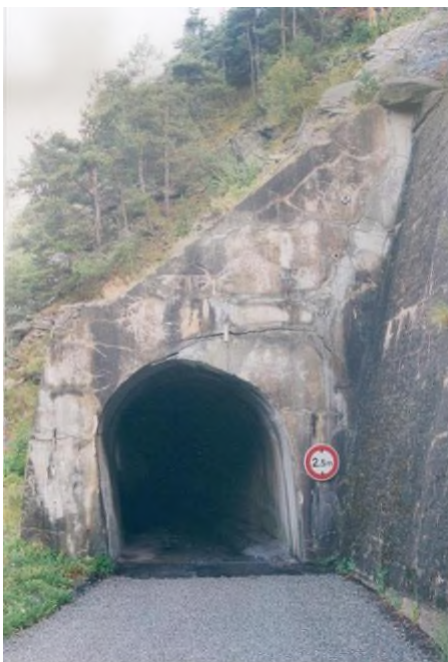
Figura 1: portale deformato dall'instabilità del pendio
