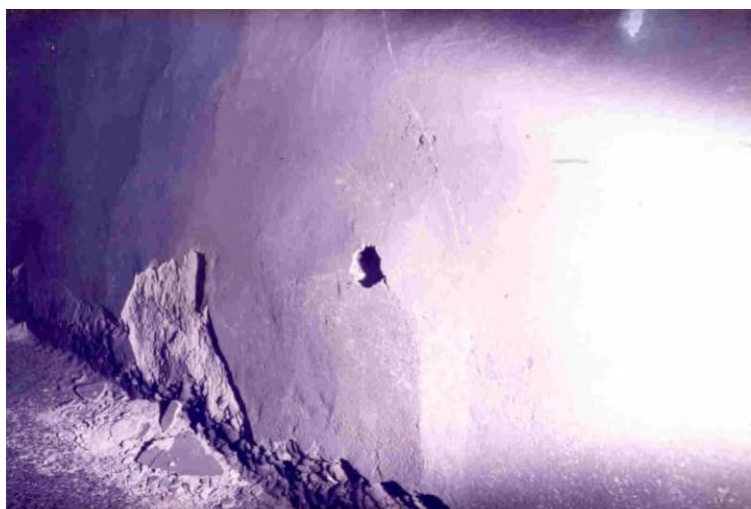
Figura 1: rivestimento allentato su calcestruzzo vecchio
