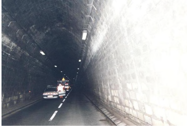
Figura 5: Deformazione asimmetrica (la parte leggera ha perso la curvatura originale)
