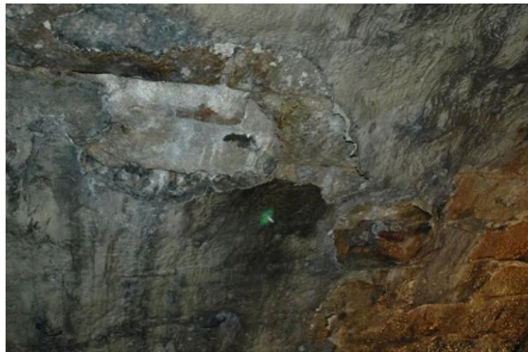
Figura 2: deterioramento di un rivestimento causato da ingresso d'acqua (a causa della scarsa manutenzione e degli effetti del gelo)
