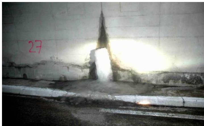
Figura 6: blocco di ghiaccio in corrispondenza di un giunto che invade il marciapiede
