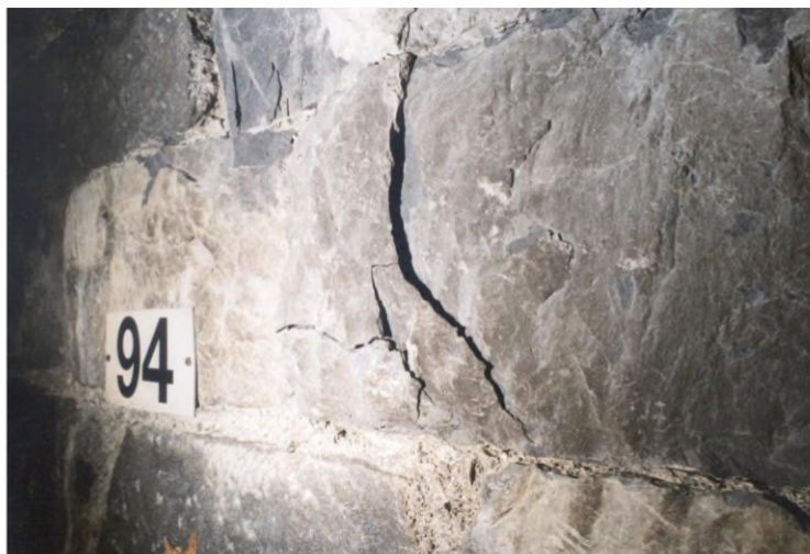
Figura 3: distacco di pietra sulla parete laterale (la lastra in distacco dista 15 mm dalla parete e non può essere staccata a mano; le pietre superiore e inferiore sono a contatto diretto, in quanto non vi è malta)
