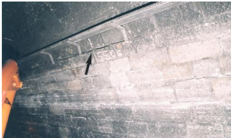
Figura 1: fessura orizzontale a seguito della deformazione della muratura
