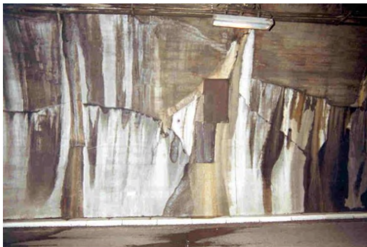
Figura 2: sviluppo della fessurazione in calcestruzzo realizzato nel 1970 senza una membrana impermeabile applicata all'estradosso
