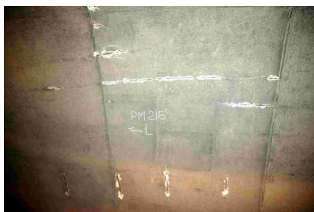
Figure 4: distacco dovuto alla corrosione e al copriferro sottile
