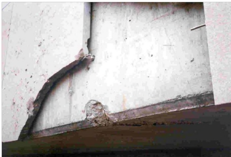
Figura 3: rivestimento distaccato e caduto a causa dell'impatto con un veicolo pesante
