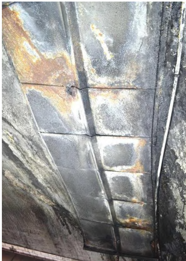
Figura 4: scarico inferiore in ancoraggio zincato, corrosivo e che perde
