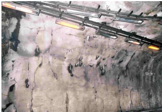
Figura 2: cemento spruzzato su superficie umida (ritiro del calcestruzzo non armato)
