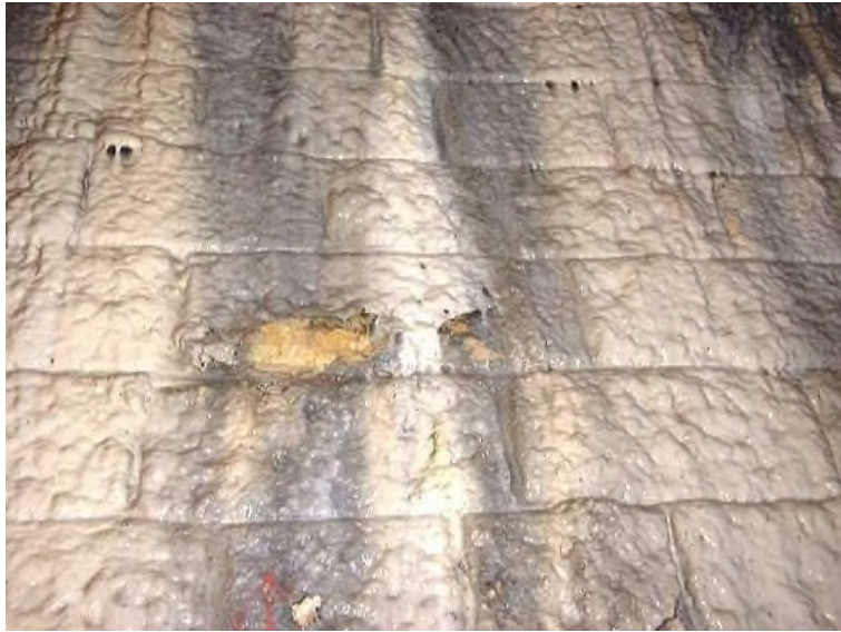
Figura 6: muratura in pietra incrostata con concrezioni calcaree
