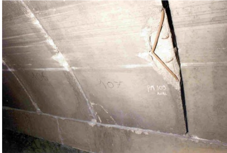
Figura 1: elemento prefabbricato sottile scheggiato a seguito di un impatto
