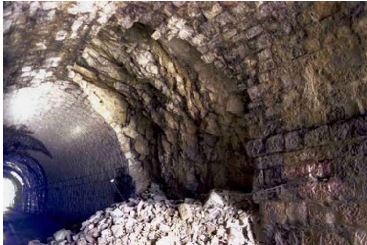
Figura 1: metà dell'arco è caduto a causa della frantumazione della parete laterale, costituita da pietre molto sfogliate e poco resistenti (questo danno permanente è stato preceduto da rigonfiamento della parete laterale, che non è stata rafforzata nel tempo; il terreno non era la causa del deterioramento)
