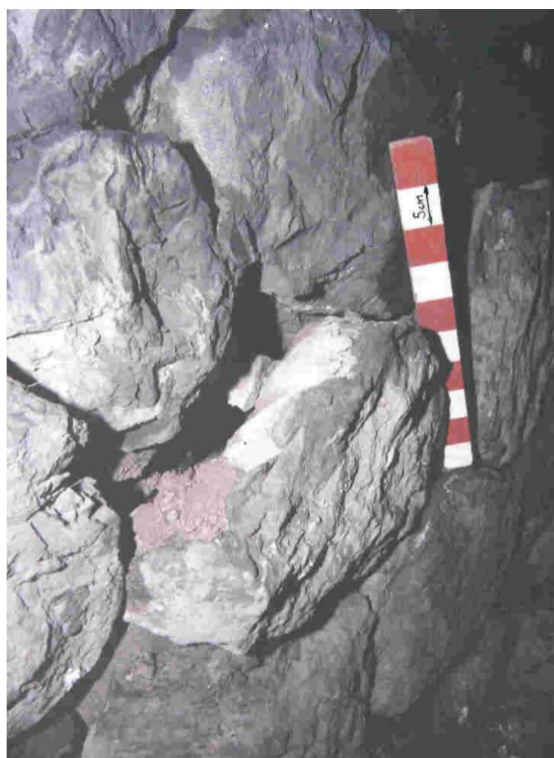
Figure 1: Perdita completa della malta, la quale porta ad un danno permanente sul piedritto
