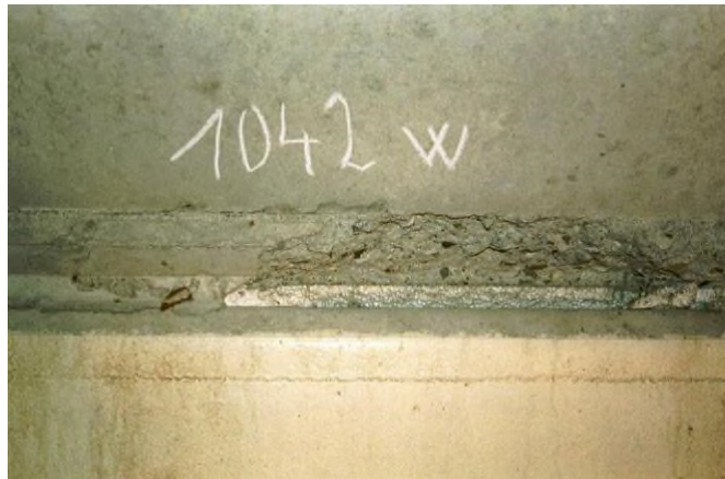
Figura 2: scheggiatura nella parte inferiore di un supporto che probabilmente si è verificato durante la rimozione della cassaforma
