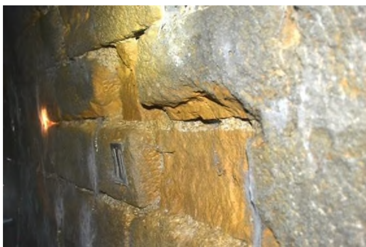
Figura 3: esfoliazione e delaminazione della muratura calcarea
