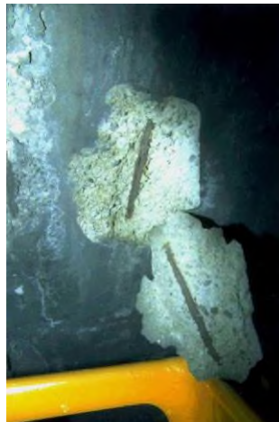
Figura 1: 2 a 3 cm di spessore di distacco a seguito della corrosione di un rinforzo (calcestruzzo dal 1963)
