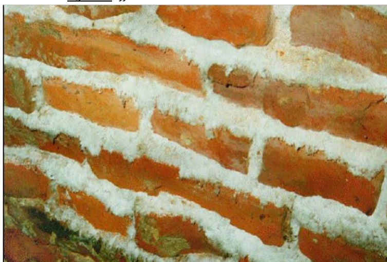
Figura 2: efflorescenza su malta vecchia a base di calce
