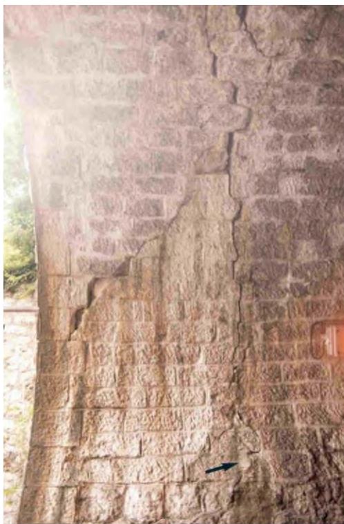
Figura 1: crepa verticale combinata con una crepa diagonale
