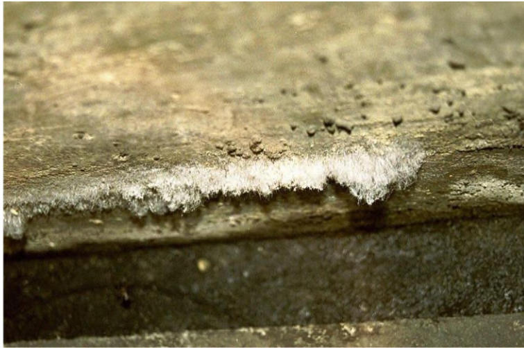
Figura 3: efflorescenza a livello del suolo sul calcestruzzo
