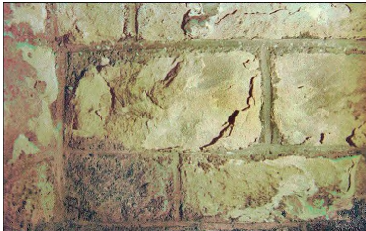
Figura 1: desquamazione superficiale di una porzione di muratura del rivestimento
