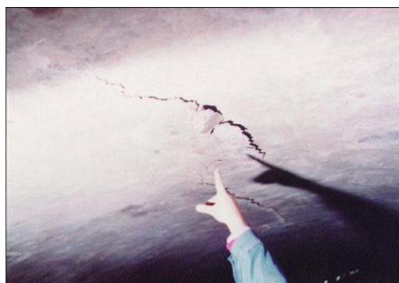
Figura 2: Inizio di rottura a taglio in calotta (si vede bene la fessura il cui bordo è fragile e vicino al distacco)
