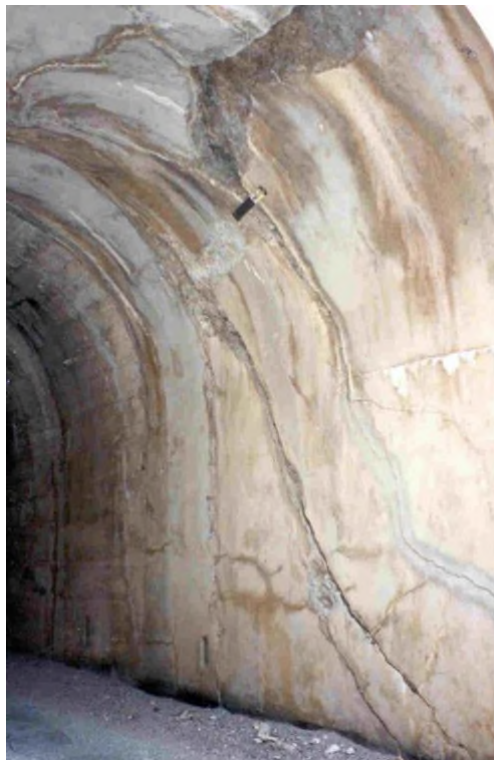
Figura 1: presenza di fessure diagonali, su rivestimento in calcestruzzo, dovute alla spinta del terreno sovrastante (una porzione di rivestimento si è distaccata cadendo sulla carreggiata – la galleria è stata chiusa pochi anno dopo)
