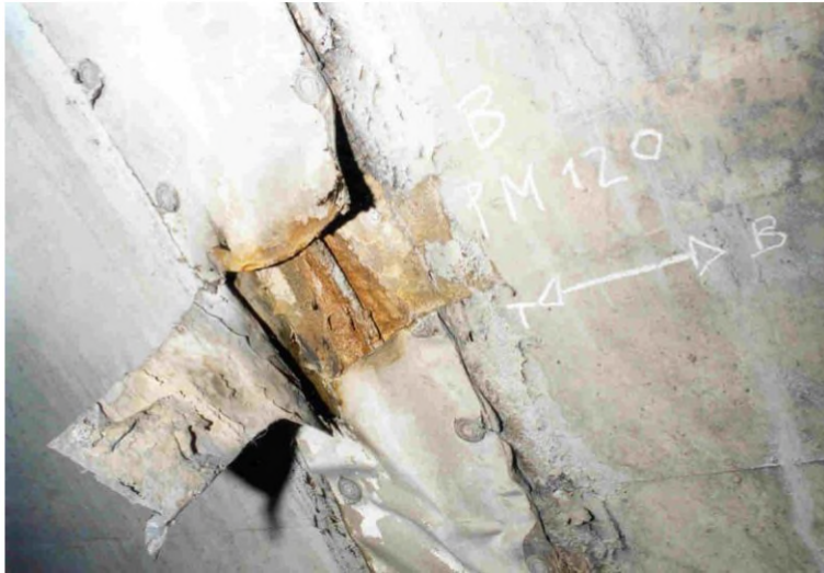
Figura 3: striscia di sigillatura e giunzione rimovibile (qui giunto PRT e striscia di Hypalon) distrutti dallo sfregamento di veicoli pesanti
