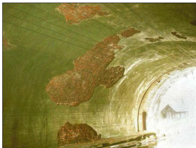
Figura 2: malta distaccata e caduta (rivestimento della galleria in mattoni)
