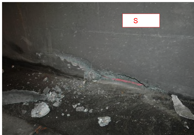
Figure 2: distacco di calcestruzzo lung oil giunto tr ail marciapiede e il piedritto
