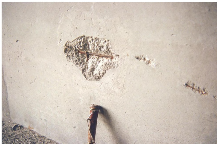
Figure 2: distacco in calcestruzzo più recente
