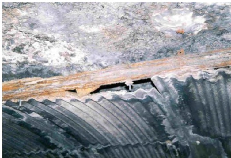
Figura 2: pannelli in fibra di cemento (ossidazione significativa degli ancoraggi con un elemento in parte distaccato)
