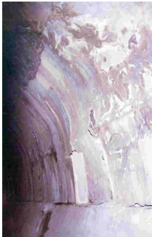
Figura 3: rivestimento danneggiato dall'azione del gelo
