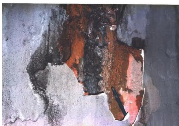
Figura 3: rottura della membrana sotto gli effetti del congelamento
