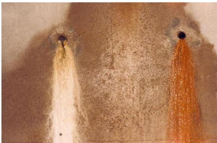
Figura 3: concrezioni di calcite leggera (a sinistra); deposito di gel rosso, ricco di ossido di ferro (a destra)
