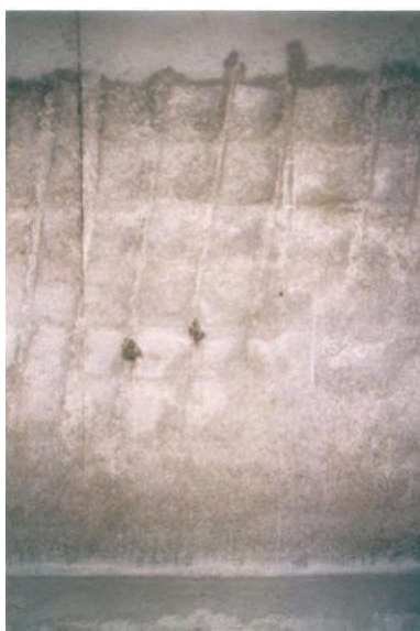
Figure 3: contorno delle barre di armature visibile sul piedritto
