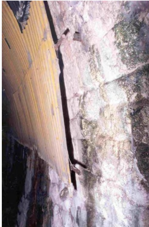
Figura 1: distacco di un'ondulina metallica e rottura dell'ancoraggio
