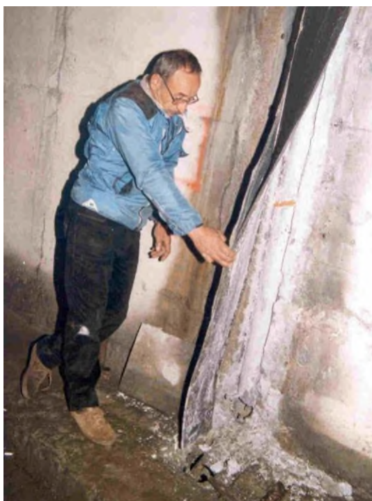
Figura 2 : pannello di sigillatura allentato (il fondo del sistema di raccolta è stato distrutto dal congelamento ed è intasato)
