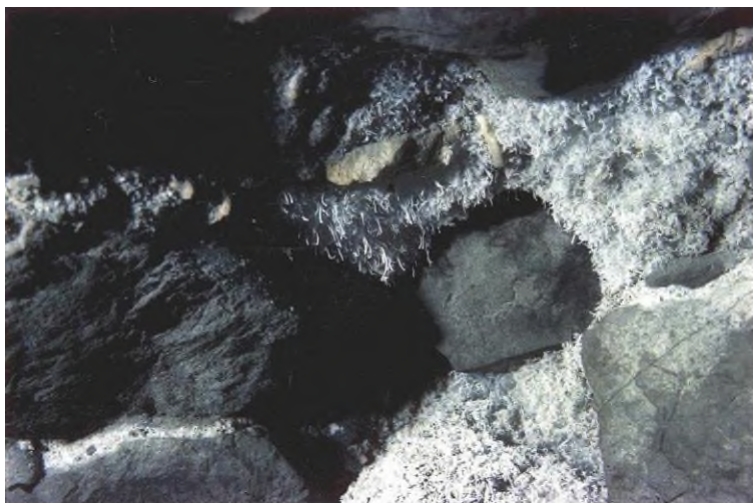
Figura 1: efflorescenza su malta vecchia a base di calce
