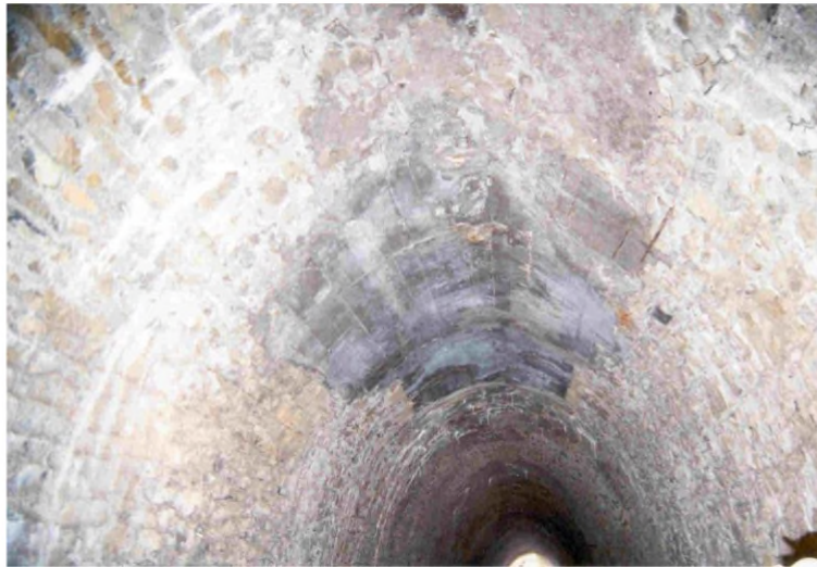
Figura 3: innalzamento in chiave (già parzialmente riparata con calcestruzzo gettato non armato, la deformazione continua schiacciando le restanti pietre della corona e il calcestruzzo)
