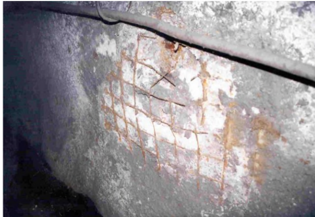
Figura 1: copertura insufficiente della rete saldata (errore di costruzione)
