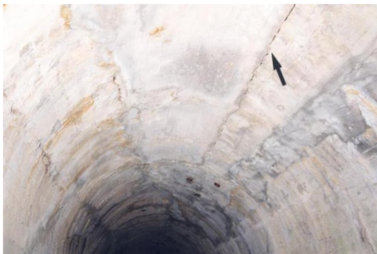
Figura 2: crepa orizzontale in calcestruzzo gettato correlata alla deformazione del rivestimento sotto la spinta del terreno circostante
