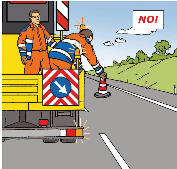
Figura 60 – Posizionamento dei coni o defleco: comportamento scorretto
